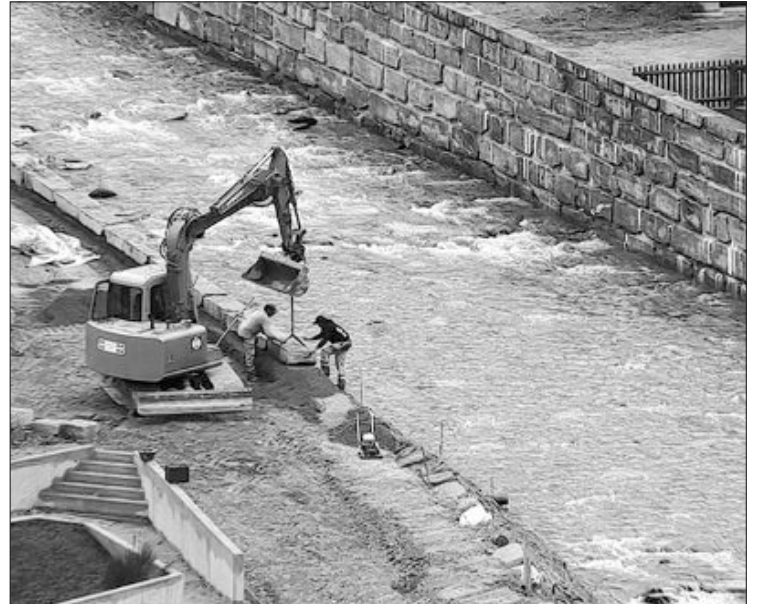
Hochwasserschutz in Vals.
